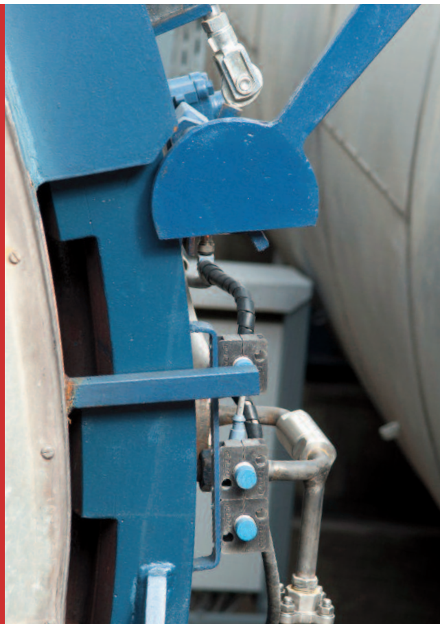
Sicherheits-Sensoren am 2.5 Tonnen schweren Deckel
